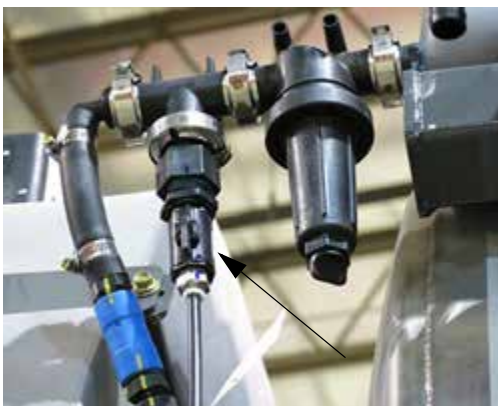
Supapă marcator cu spumă (lângă partea din spate a rezervorului de clătire) - Vedere tipică
