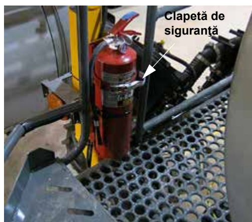
Extinctoare (de-a lungul punții de acces, pe partea stângă a utilajului) - Vedere tipică
