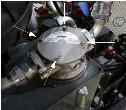
Filtrului de retur hidraulic (pe partea stângă a utilajului - lângă rezervorul de ulei hidraulic) - Vedere tipică
