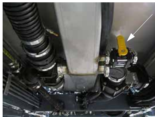
Supapă de drenare a rezervorului de soluție (sub rezervorul de soluție de sub utilaj) - Vedere tipică
