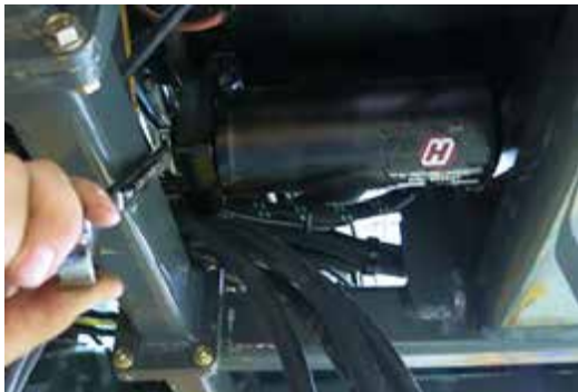
Tápszivattyú szűrő (a hajtott szivattyú alatt van elhelyezve) – Tipikus nézet
