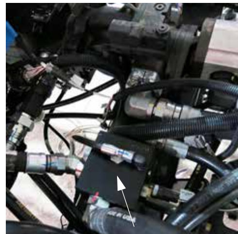
Permetlé szivattyú vezérlő elosztó (közel a gép közepéhez) – Tipikus nézet * A berendezés felülnézete
