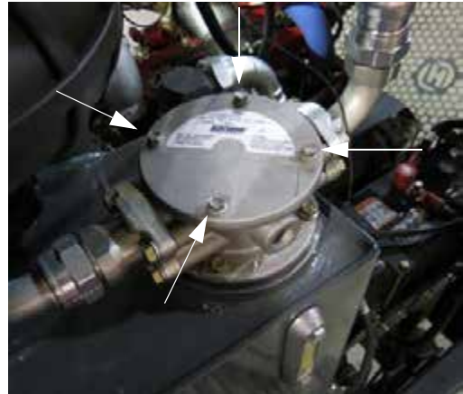
Carcasa del filtro de retorno (ubicada en el lado izquierdo de la máquina, cerca del depósito de aceite hidráulico) -Vista típica
