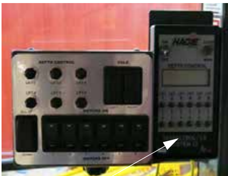
Panel de control de Tasselrol -Vista típica
