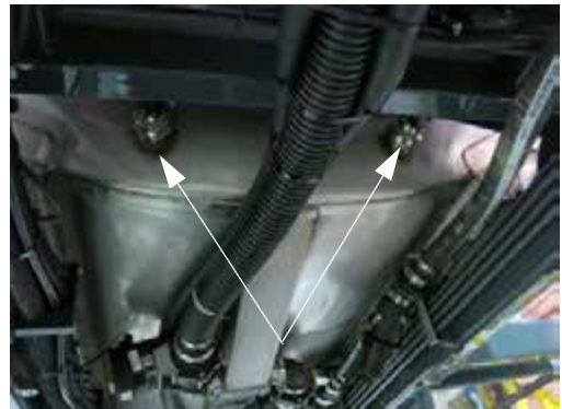
Agitadores de chorro (dos ubicados en cada extremo del tanque de solución) -Vista típica
