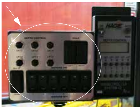
Panel de control de despenachado -Vista típica
