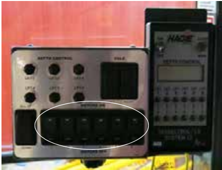
Interruptores de control del motor (ubicados en el panel de control de despenchado) -Vista típica
