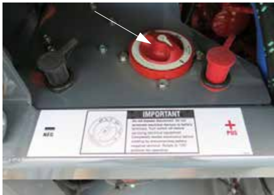
Interruptor de desconexión de las baterías (ubicado en el bastidor principal trasero) -Vista típica
