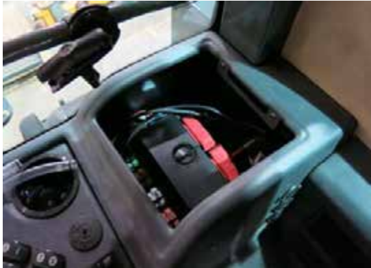
Interruptores automáticos / fusibles (interiores) (ubicados en la parte trasera de la consola lateral; quite la bandeja para tener acceso) -Vista típica
