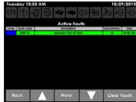
Pantalla de fallas del sistema
