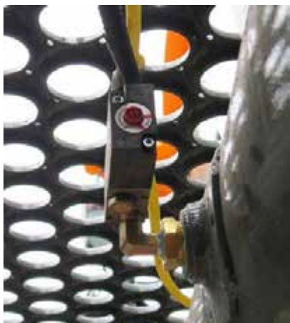
Válvula de control piloto (situada cerca del tanque de aire) -Vista típica
