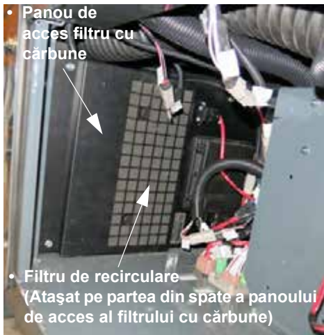
Panou de acces filtru cu cărbune (amplasat în spatele panoului de revizie exterior, pe partea dreaptă a cabinei) - Vedere tipică
