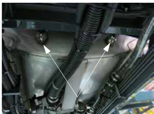
Agitatoare de jet (Două amplasate pe fiecare capăt al rezervorului de soluție) - Vedere tipică
