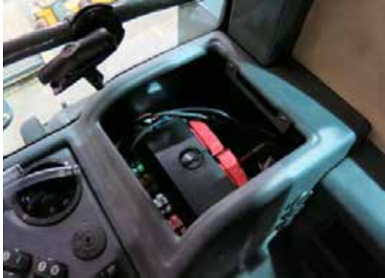
Întrerupătoare de circuit/Siguranțe (interior) (amplasate pe consola laterală - demontați tava pentru a le accesa) - Vedere tipică
