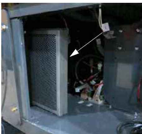
Filtru cu cărbune - Vedere tipică
