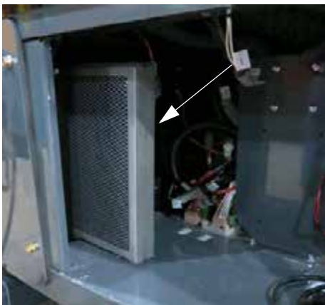
Filtru cu cărbune - Vedere tipică
