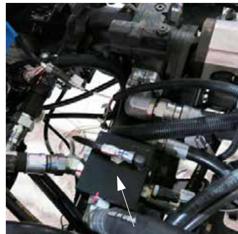
Permetlé szivattyú vezérlő elosztó (közel a gép közepéhez) – Tipikus nézet * A berendezés felülnézete
