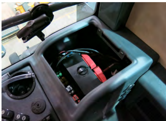
断路器/熔丝（内部） （位于侧控制台的后侧 – 拆除托 盘后可以够着） - 典型视图
