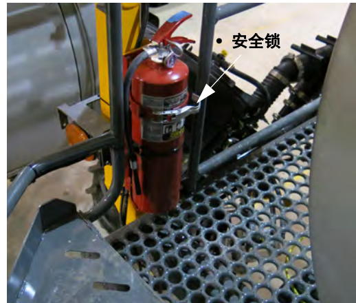
灭火器 (位于机器左手侧的小通道上) - 典型视图
