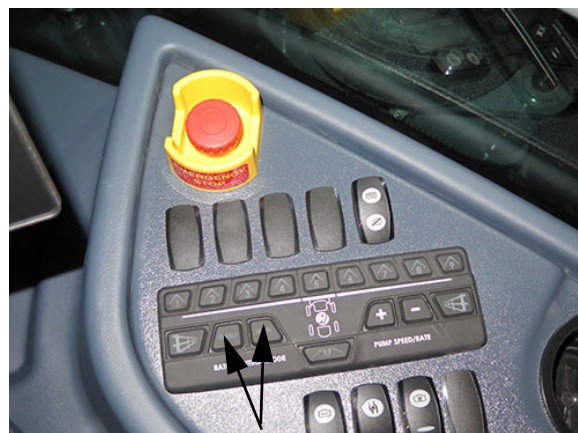
Mérték szabályzó kapcsolók (oldalsó vezérlőpulton) – Tipikus nézet
