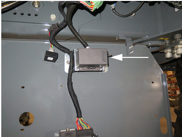
Cutie de relee pompă de soluție (amplasată sub capătul din față al cabinei - coborâți panoul pentru acces) - Vedere tipică
