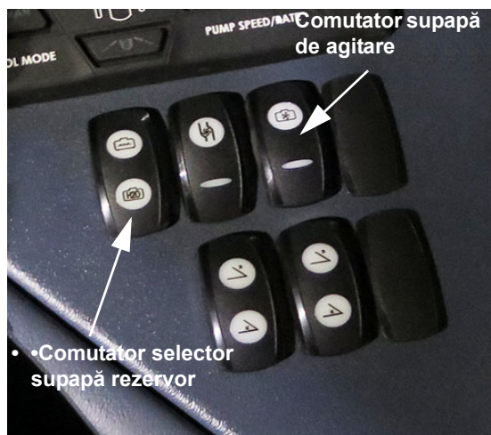
Selector supapă rezervor și comutatoare supapă de agitare (pe consola laterală) - Vedere tipică
