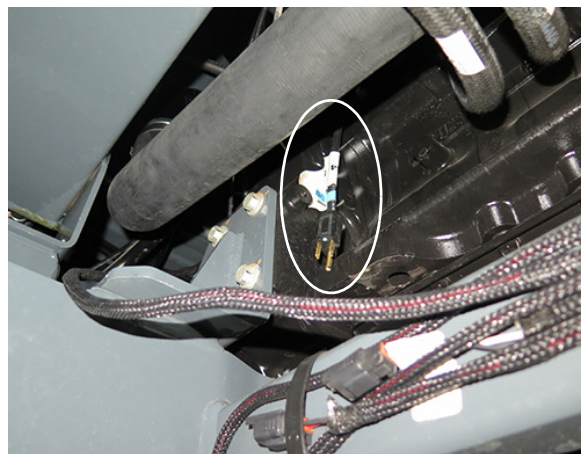
Cablu de alimentare încălzitor bloc motor - STS10/STS12 (amplasat sub motor pe partea stângă a utilajului) - Vedere tipică
