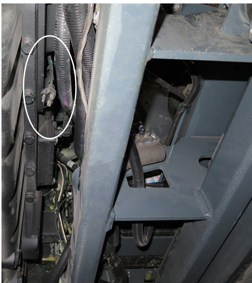
Cablu de alimentare încălzitor bloc motor - STS14/STS16 (amplasat sub utilaj pe partea dreaptă a motorului) - Vedere tipică
