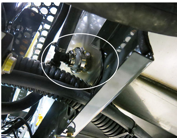
Agitatoare de jet (pe fiecare capăt al rezervorului de soluție) - Vedere tipică
