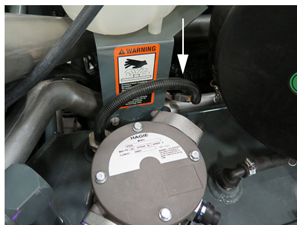
Snímač úrovne hladiny/teploty (Nachádza sa navrchu nádrže na hydraulický olej) - Typický pohľad
