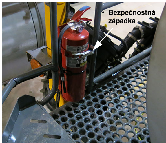
Hasiaci prístroj (Nachádza sa na plošine na ľavej strane stroja) - Typický pohľad
