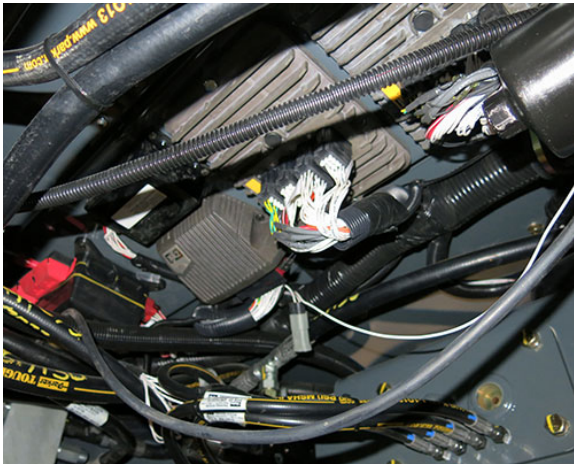
Ističe/poistky (exteriér) (Nachádzajú sa pod kabínou - odstráňte panel na získanie prístupu) - Typický pohľad
