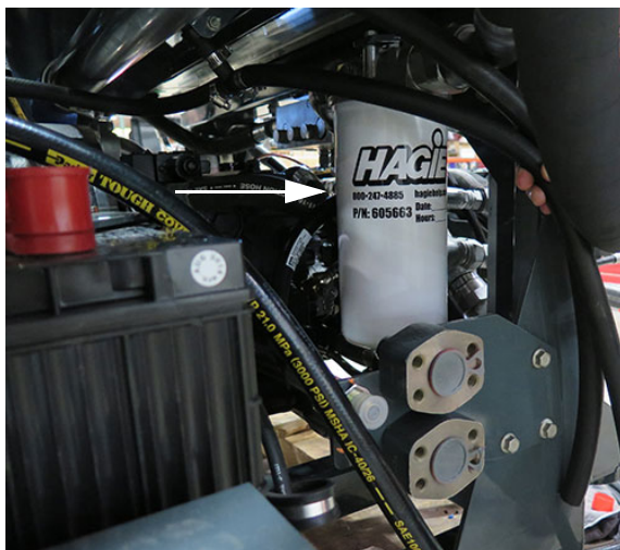
Vypúšťací filter skrine 1 (Nachádza sa na pravej strane stroja v blízkosti batérií) - Typický pohľad
