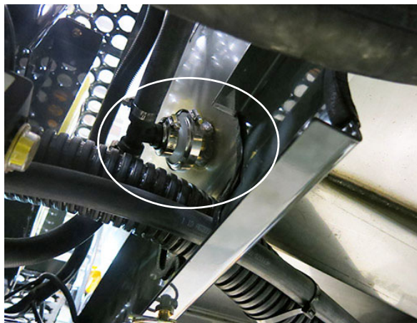
Prúdový miešač (Nachádza sa na každom konci nádrže na roztok) - Typický pohľad
