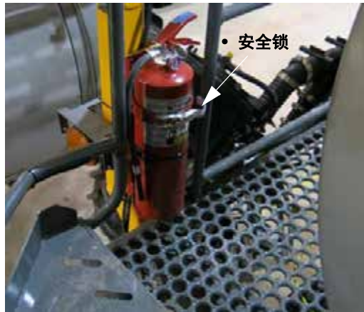
灭火器 (位于机器左手侧的平台上) - 典型视图
