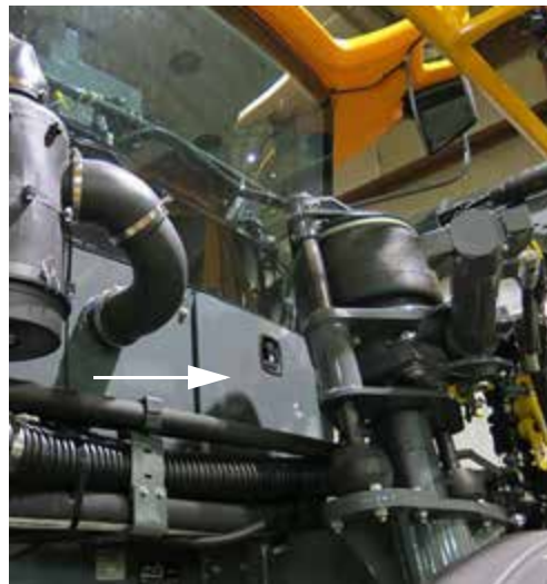
室外检修面板 (位于驾驶室的右手侧) - 典型视图
