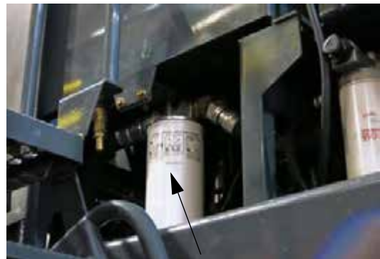
箱体排油管过滤器 (位于机器左手侧) - 典型视图
