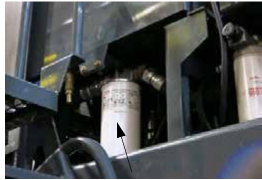
箱体排油过滤器 (位于机器左侧) - 典型视图
