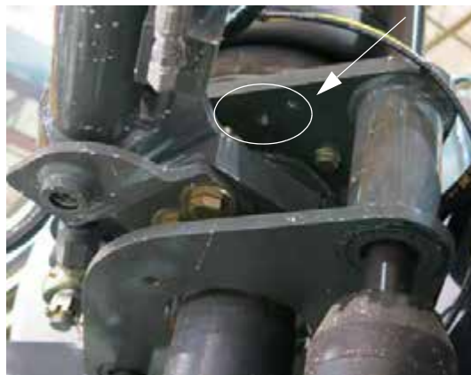
衬圈润滑油加油嘴 (位于每个气囊座板之下) - 典型视图
