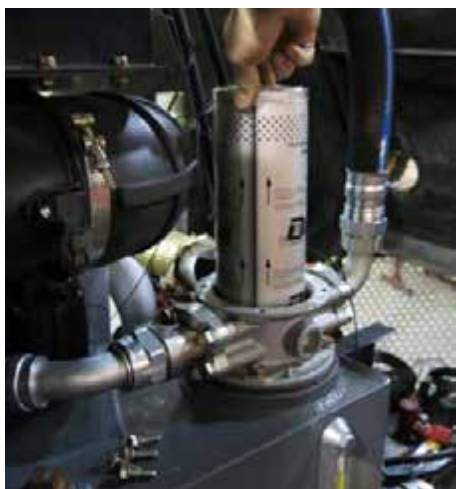
回油过滤器 (位于机器左侧的过滤器外壳内) - 典型视图
