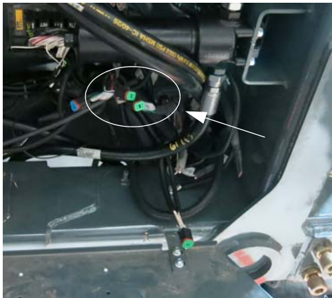
视频摄像头输入接口 （位于驾驶室下方 - 拆除前面板 后可以够着） - 典型视图
