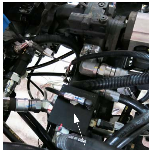
药液泵控制歧管 (位于机器中心附近) - 典型视图 * 机器上方的俯视图
