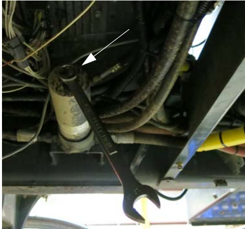
压力过滤器外壳 (位于机器右手侧 - 降低 金属护板可以够着) - 典型视图
