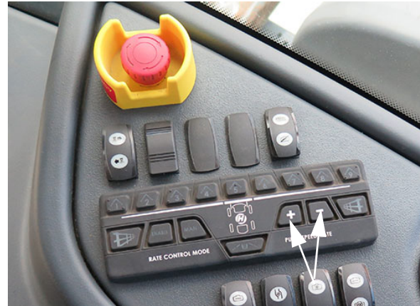
Interruptores de tasa/velocidad de la bomba (ubicados en la consola lateral) -Vista típica
