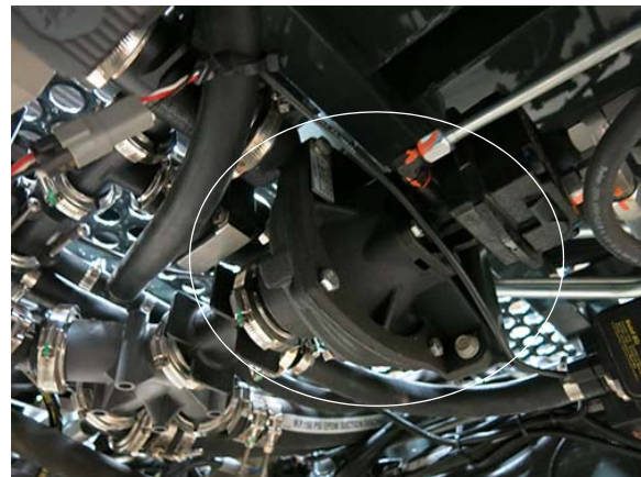
Pompe à solution (située sous la partie centrale de la machine) - Vue typique
