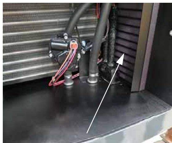
Filtre de recirculation (situé sur le côté droit du compartiment) - Vue typique
