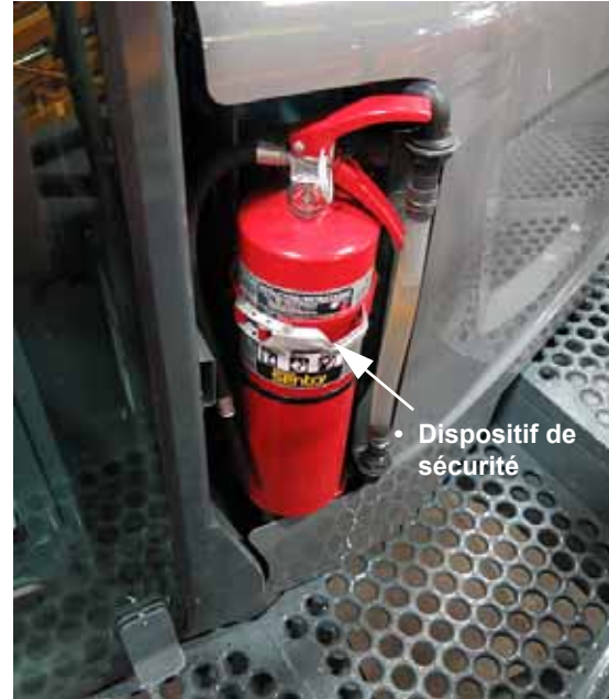
Extincteur d'incendie (situé derrière la partie gauche de la cabine) - Vue typique
