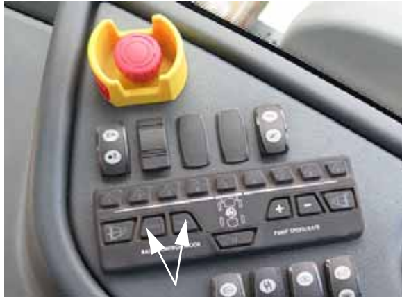
Commutateurs de contrôle du dosage (situés sur la console latérale) - Vue typique
