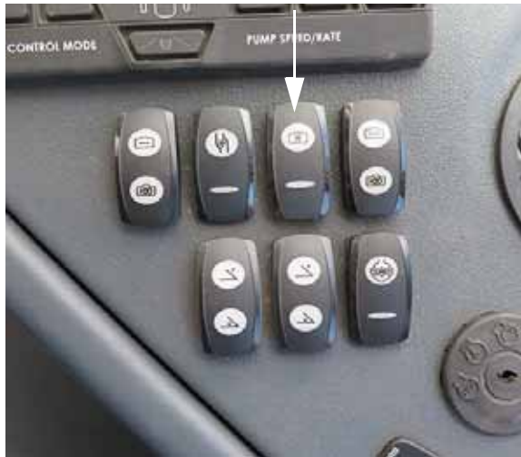
Commutateur de la vanne de brassage (situé sur la console latérale) - Vue typique
