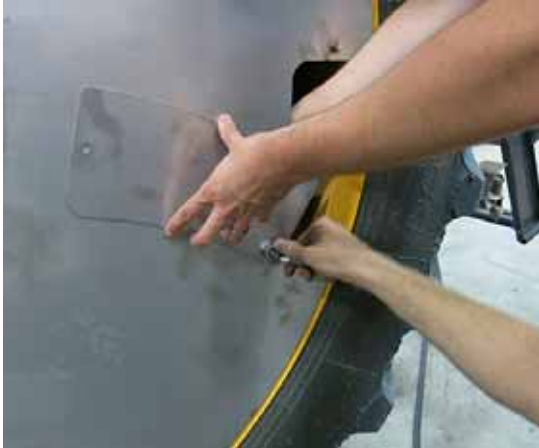
Panneau d'accès à la tige de valve de chambre à air - Vue typique
