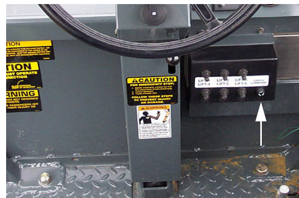
Fusible del control de profundidad (ubicado en el panel del interruptor del control de profundidad, cerca de la parte delantera del puesto del operador) -Vista típica
