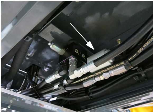
Filtro en línea de alta presión (ubicado debajo de la máquina, baje el panel delantero de la pantalla y retírelo para acceder) - Vista típica
