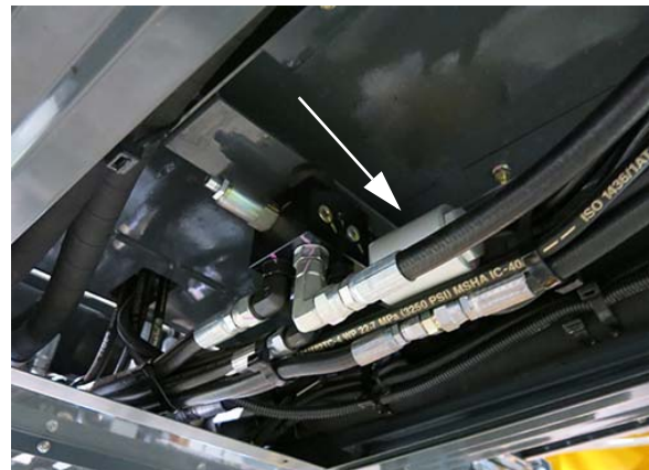
Filtro en línea de alta presión (ubicado debajo de la máquina, bajo el panel delantero de la pantalla y retírelo para acceder) - Vista típica
