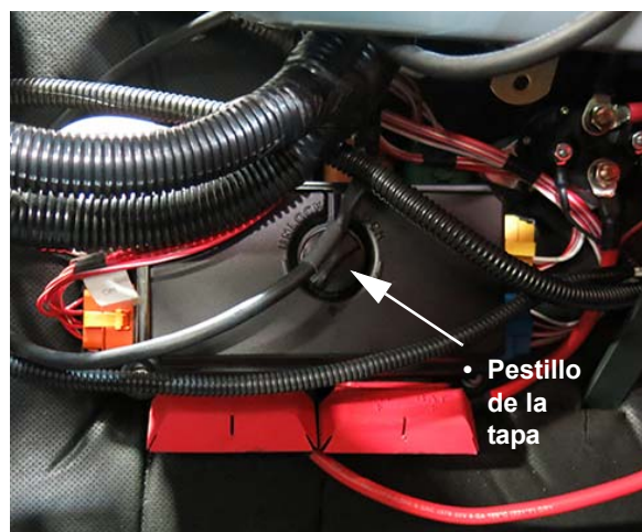
Caja de fusibles/relés (ubicada cerca del piso, debajo de la consola lateral) - Vista típica
