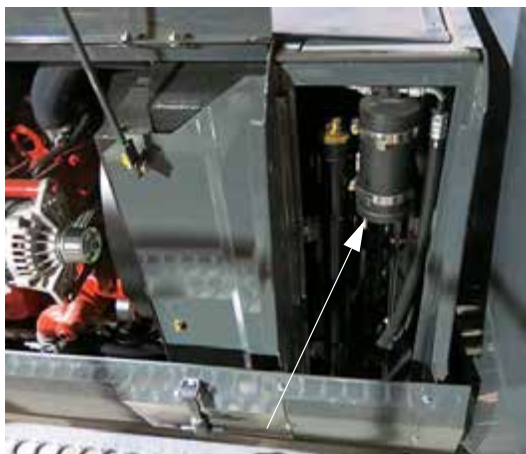
Receptor/secador del sistema de aire acondicionado (ubicado detrás de la cabina cerca del radiador, quite las pantallas del radiador para acceder) -Vista típica
