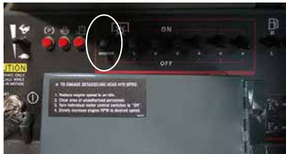
Interruptor principal de la despenachadora (ubicado en la consola lateral) -Vista típica
