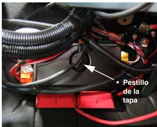
Caja de fusibles/relés (ubicada cerca del piso, debajo de la consola lateral) - Vista típica
