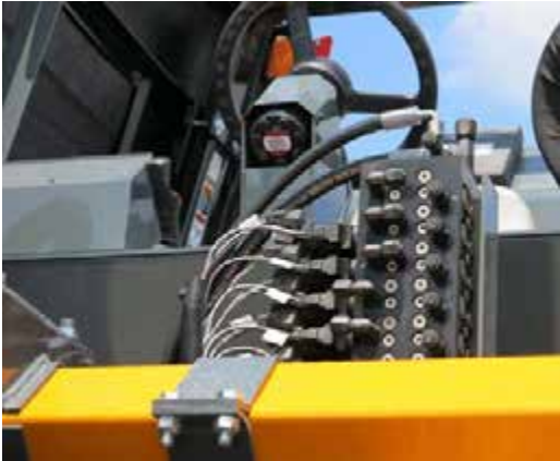
Válvulas electro-hidráulicas (ubicadas en la parte delantera de la barra de herramientas) -Vista típica
