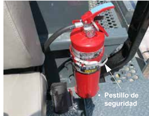
Extintor de incendios (ubicado junto al asiento del operador) -Vista típica
