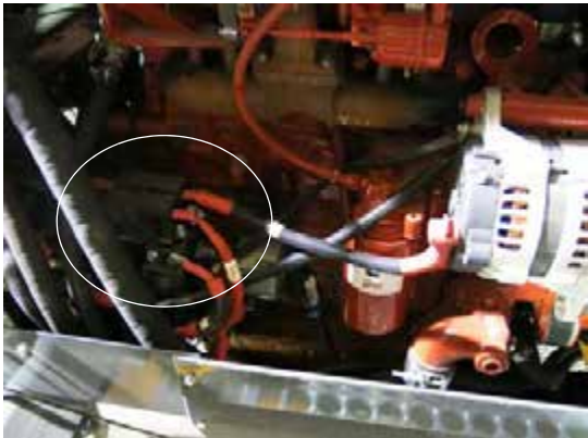
Fusibles e interruptores automáticos del arnés de cableado (ubicados en el lado izquierdo del motor) -Vista típica
