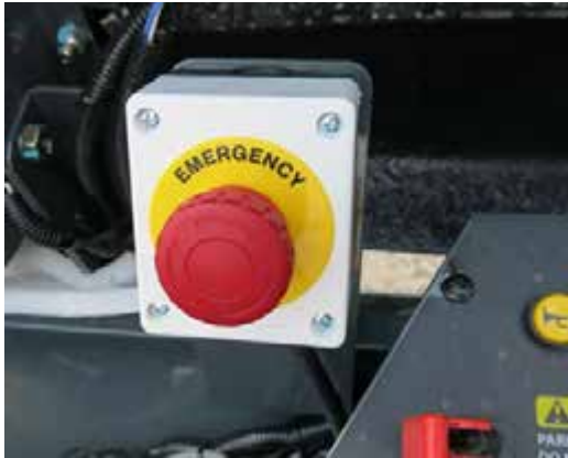
Botón de parada de emergencia (ubicado cerca de la consola lateral) -Vista típica
