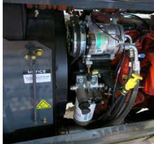
Puerto de carga del aire acondicionado -Vista típica
