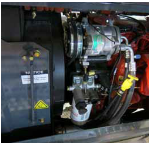
Port de încărcare sistem de aer condiționat - Vedere tipică
