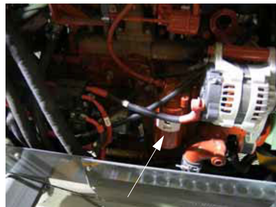
Filtrul de ulei de motor (pe partea dreaptă a motorului - deschideți capota pentru acces) - Vedere tipică
