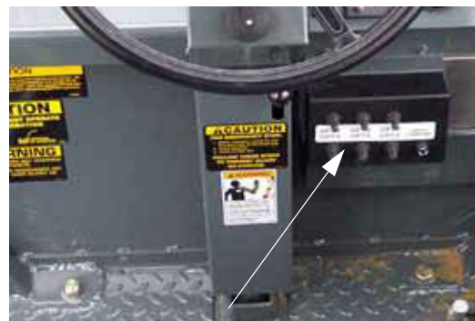
Comutatoare comandă de adâncime (lângă partea frontală a stației operatorului) - Vedere tipică
