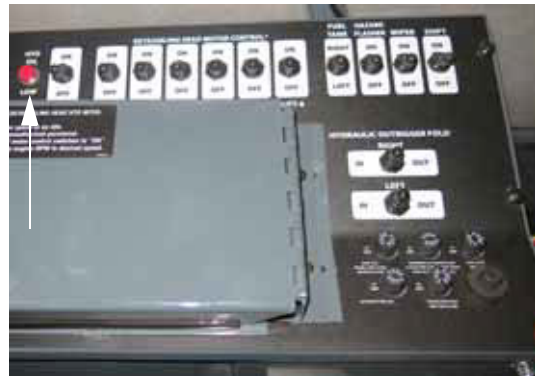
Indicator de ulei hidraulic scăzut (pe consola laterală) - Vedere tipică
