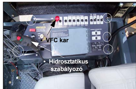
Megszakítók (Az oldalkonzolon található) -Jellemző nézet
