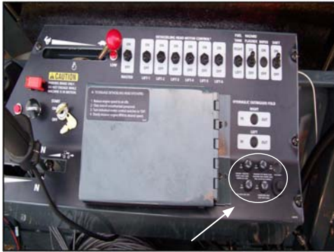
الصمامات الكهربائية (الموجود على وحدة التحكم الجانبية) - عرض نموذجي
