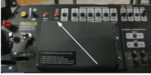
مؤشر مستوى انخفاض الزيت الهيدروليكي (الموجود على وحدة التحكم الجانبية) - عرض نموذجي
